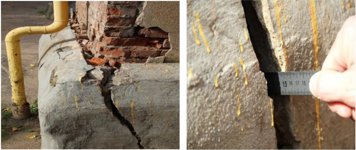
Рис. 7. Трещины в цоколе
