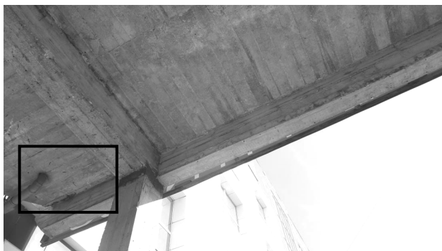
Рис. 2. Общий вид оголовка колонны. Трещины шириной раскрытия до 7 мм
