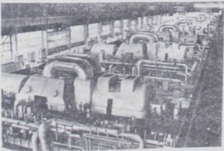
ТЮМЕНСКАЯ ОБЛАСТЬ. Сургутская ГРЭС — энергетическое сердце Ханты-Мансийского автономного округа. Это самая северная и мощная электростанция в стране, работающая на попутном нефтяном газе.
