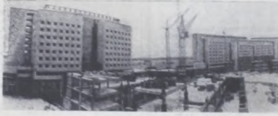
МОСКВА. Широкие, светлые окна, просторные холлы, отделанные красными современными материалами. — это готовые помещения корпусов Всесоюзного кардиологического центра, сооружаемого на средства коммунистического субботника. Центр расположен возле Рублевского лесопарка столицы.
