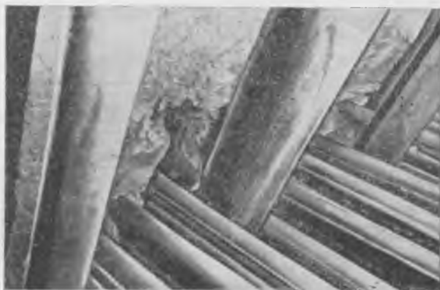
Рис. 5. Проход труб перегревателя через наклонное перекрытие после 4300 час. работы.
