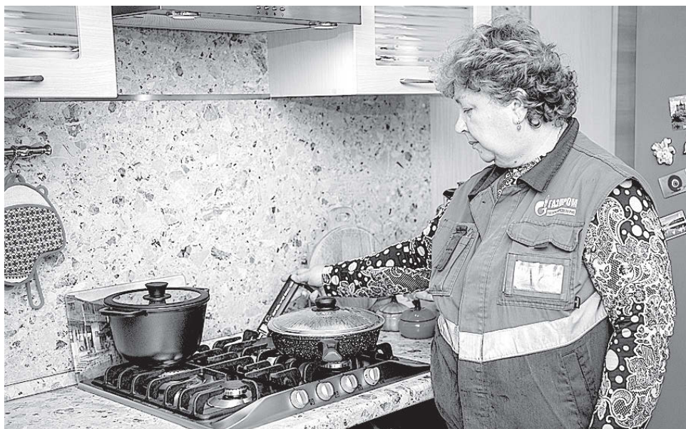
Газовики зафиксировали 40 случаев утечки газа на неправильно смонтированном оборудовании. | Фото предоставлено ООО «Газпром межрегионгаз Вологда»
