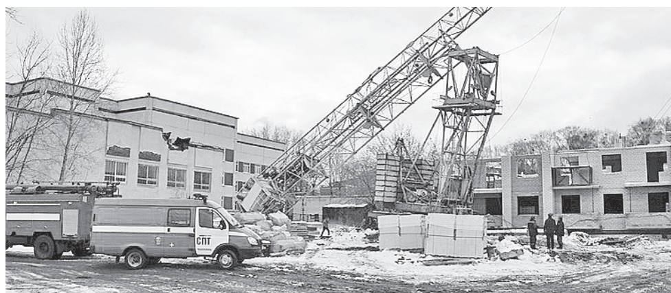
Рухнувший кран повредил крышу пристройки поликлиники с бассейном. | Фото http://cherinfo.ru/
