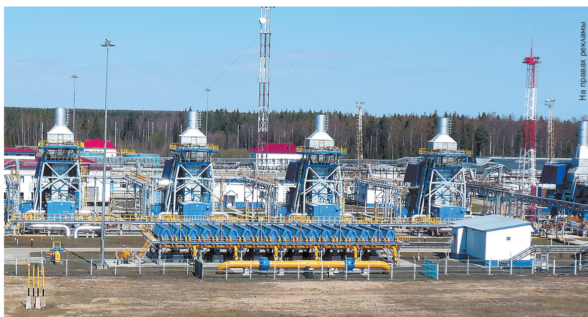
Расположенные на вологодской земле компрессорные станции постоянно модернизируются: работа по их обслуживанию непростая, но интересная.
