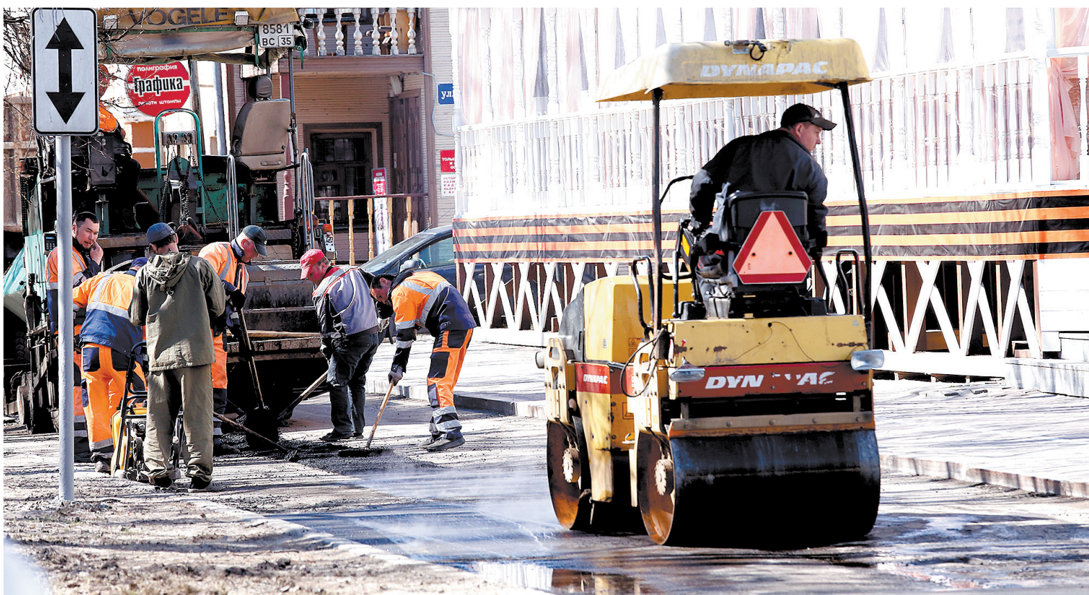
200 миллионов рублей из выделенной суммы будет направлено на ремонт наиболее разрушенных участков дорог областного центра. | Фото Валентины Певцовой
