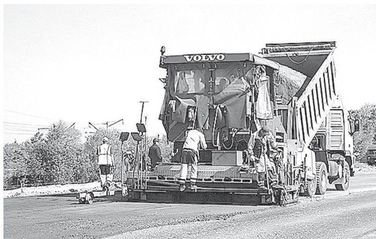
Объем ямочного ремонта в области постоянно растет.
