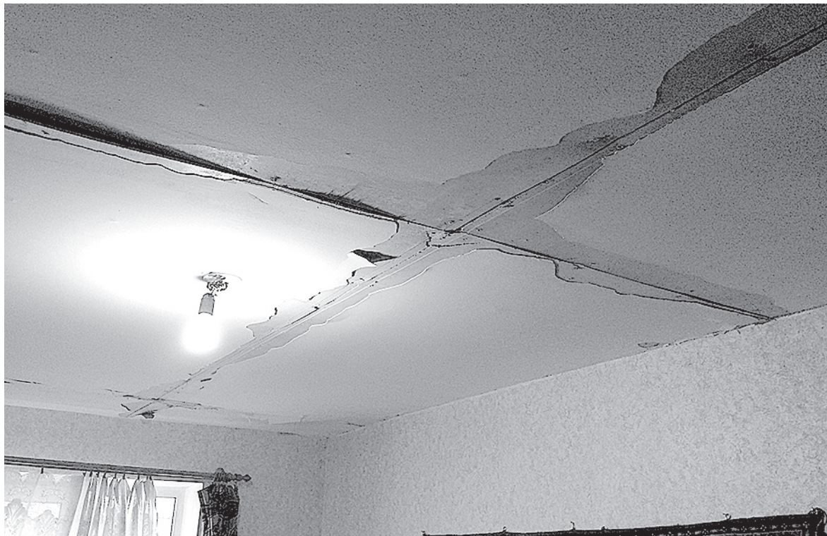
Внутри квартир складываются стены и падают потолки.
