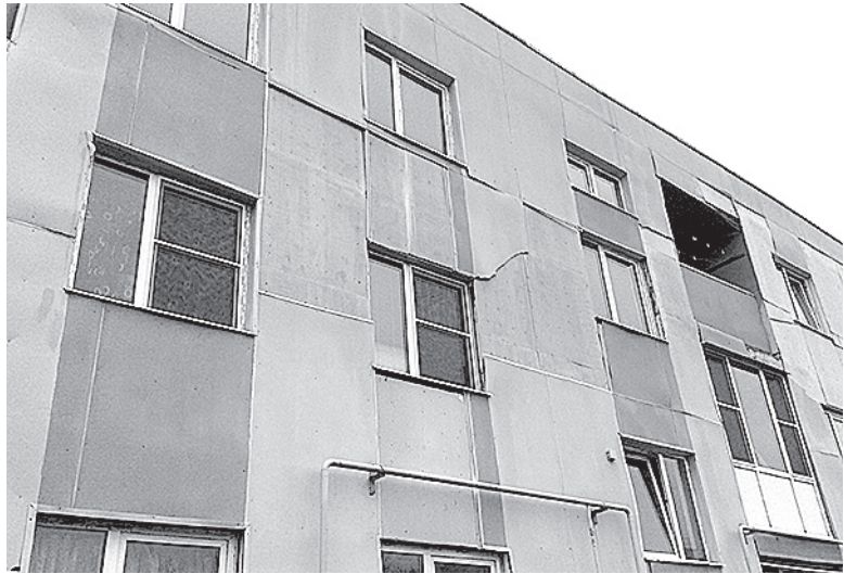
Со здания снаружи отлетают плиты, сделанные из стекломгнезита.
