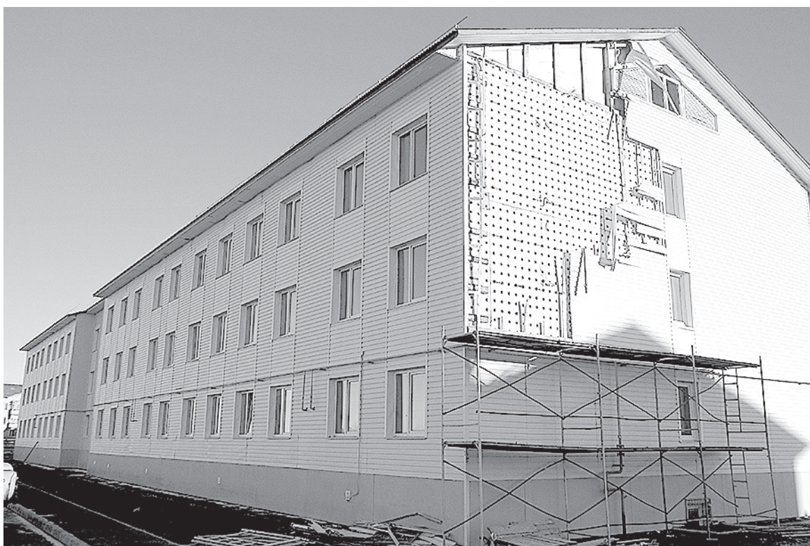
По предположению рабочих, выполняющих ремонт фасада, сайдинг могло сорвать из-за того, что либо неправильно были закреплены направляющие, либо между панелями была щель.
