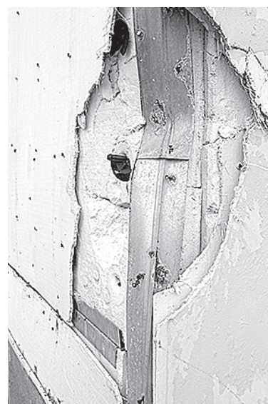
Такие повреждения мы увидели на стене здания.
