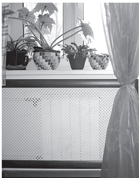
Современные радиаторы позволяют экономить на теплоэнергии.
