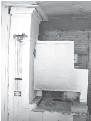
Печь в медпункте Межурок давно требует ремонта. /Фото автора
