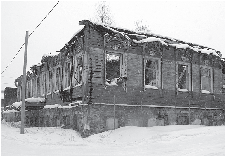
Жительница Устюжны выразила обеспокоенность состоянием памятников федерального значения в своем городе.
