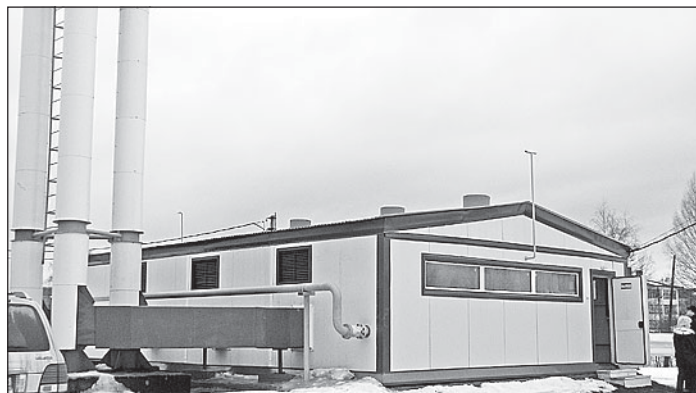
Благодаря вводу в строй новой газовой котельной в домах жителей деревни Коротово появились тепло и горячая вода.
