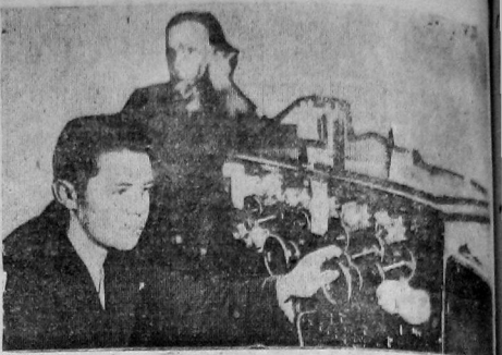
К Октябрьскому празднику полностью переоборудован мощный Вологодский радио-узел. На фото—техники гг. Бончаров и Сурганов у пульта автоматического управления радиоузелом
