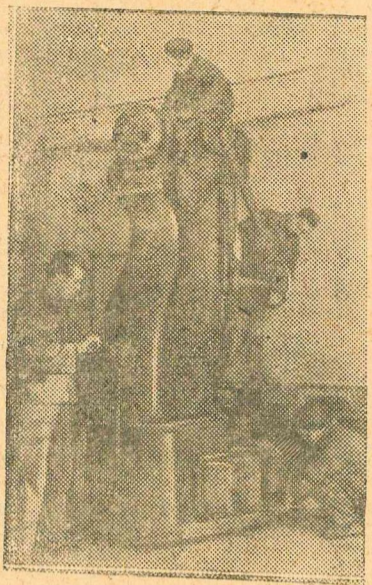
Бригада слесарей-монтажников С. Я. Тютюкова устанавливает большой координатно-расточный станок в новом цехе Н-ского завода в Ленинграде.
