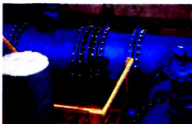
Трубопровод из ВЧШГ
