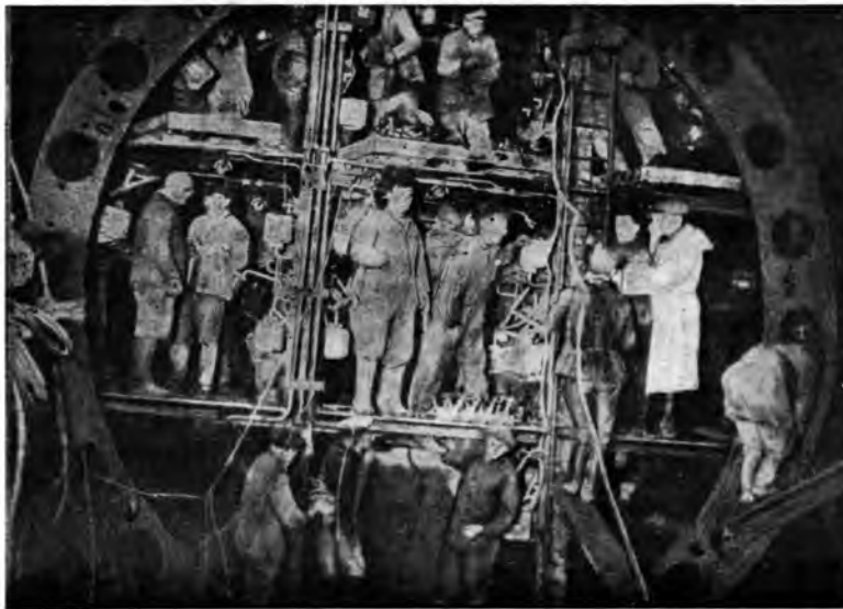
15. Работа в щите
