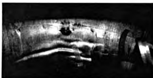
Рис. 1. Канал пробоя № 2 в бумаге на внутренней части рыма между 3- и 4-й обкладками на месте технологической подрезки лент
