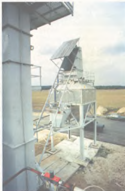
Современный бункер-накопитель асфальтобетона.
