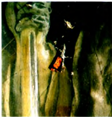
Илл. 5. Разрушение красочного слоя от попадания кирпича. Северная стена.
