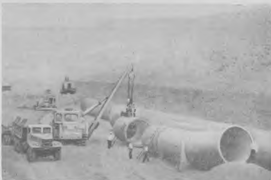
Рис. 4. Трубы на трассе Большого Алма-Атинского канала
