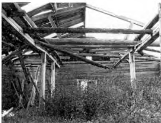
Ил. 15. Полуразрушенная трапезная 1902 г. Вид на западную сторону. Фотография автора. 2009
